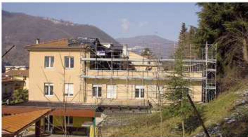
Ecco come appariva la Casa di riposo «Madre Teresa di Calcutta» durante i lavori per l'ampliamento, che stanno per concludersi
